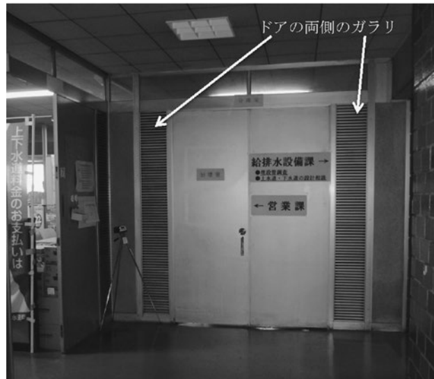
図9-1 ドアの両側にガラリがある喫煙室の外観
